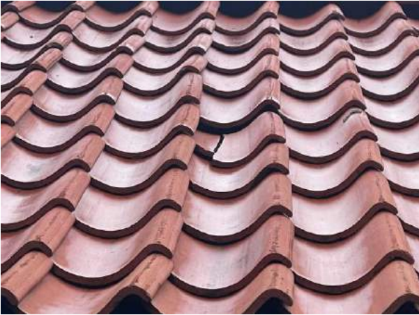
Bild 7: Utvändigt, Yttertak, - Det förekommer spruckna skadade tegelpannor. För att minska risken för fuktrelaterade skador på underlagstaket måste dessa ersättas.
