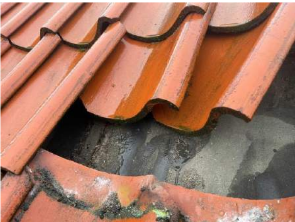
Bild 11: Utvändigt, Yttertak, - Det förekommer spruckna skadade tegelpannor. För att minska risken för fuktrelaterade skador på underlagstaket måste dessa ersättas.
