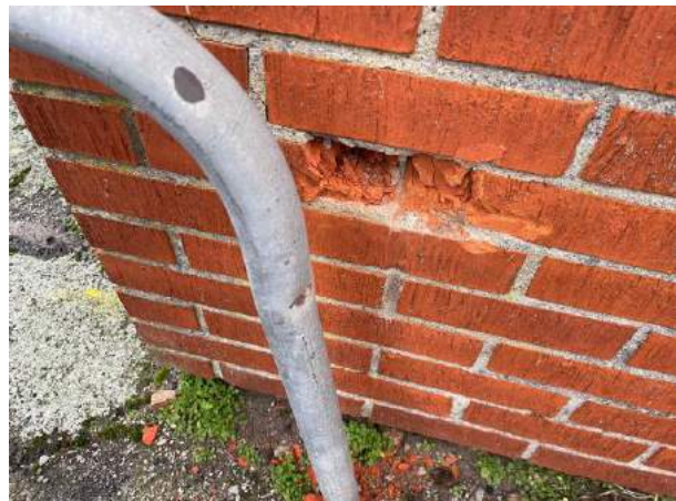
Bild 24: Utvändigt, Fasad, - Påkörningskada noteras på ena garagets gavel.
