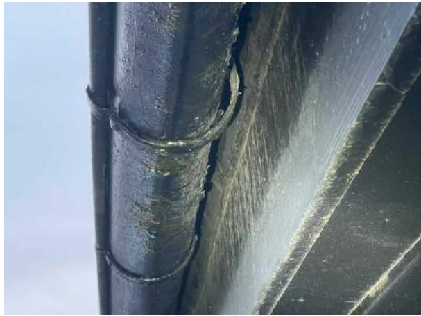
Bild 14: Utvändigt, Avvattning, - Läckage noteras på hängrännorna. Innebär ökad fuktbelastning på träpanelerna och garageportarna vilket tydligt syns vid nederbörd.
