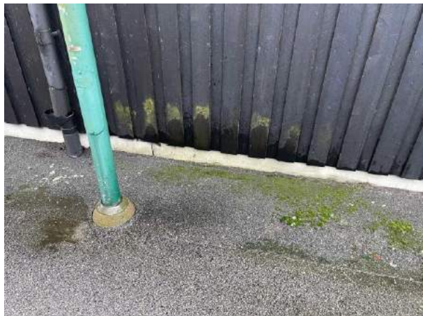
Bild 16: Utvändigt, Avvattning, - Läckage noteras på hängrännorna. Innebär ökad fuktbelastning på träpanelerna och garageportarna vilket tydligt syns vid nederbörd.
