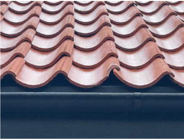
Bild 13: Utvändigt, Yttertak, - Det förekommer många vridna takpannor. Framför allt i nederkant. Har skett efter stormar. Dessa bör återplaceras så det ligger tätt mot...
