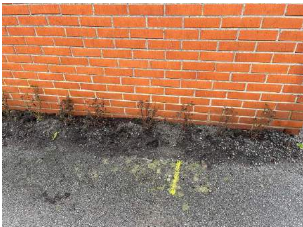
Bild 25: Utvändigt, Fasad, - På ena gaveln ligger det matjord upp på murverket. Innebär ökad fuktbelastning och risk för frostsprängningar i tegelstenarna.
