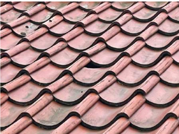
Bild 9: Utvändigt, Yttertak, - Det förekommer spruckna skadade tegelpannor. För att minska risken för fuktrelaterade skador på underlagstaket måste dessa ersättas.
