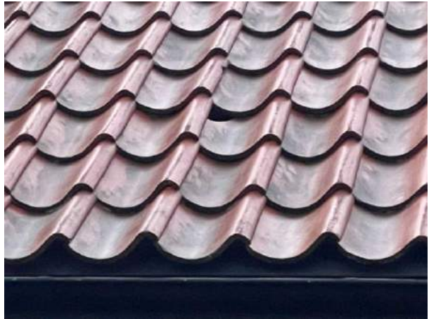
Bild 2: Utvändigt, Yttertak, - Det förekommer spruckna skadade tegelpannor. För att minska risken för fuktrelaterade skador på underlagstaket måste dessa ersättas.
