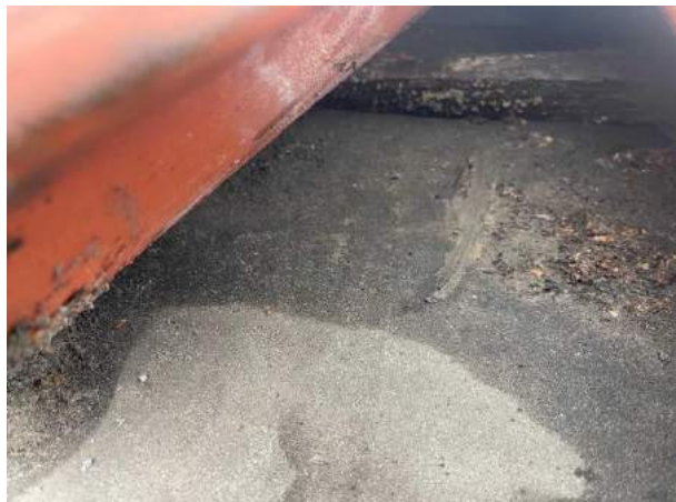
Bild 10: Utvändigt, Yttertak, - Det förekommer spruckna skadade tegelpannor. För att minska risken för fuktrelaterade skador på underlagstaket måste dessa ersättas.
