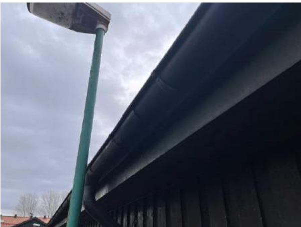
Bild 17: Utvändigt, Avvattning, - Läckage noteras på hängrännorna. Innebär ökad fuktbelastning på träpanelerna och garageportarna vilket tydligt syns vid nederbörd.
