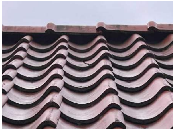
Bild 4: Utvändigt, Yttertak, - Det förekommer spruckna skadade tegelpannor. För att minska risken för fuktrelaterade skador på underlagstaket måste dessa ersättas.
