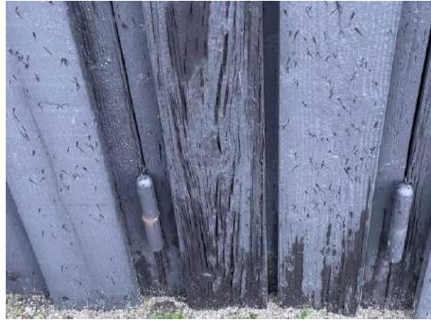
Bild 20: Utvändigt, Fasad, - Mycket träpanel har kontakt med marken vilket innebär risk för förtida fuktskador. Rekommenderar minst 15mm luftspalt mellan panel och...
