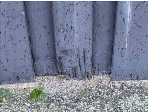
Bild 21: Utvändigt, Fasad, - Mycket träpanel har kontakt med marken vilket innebär risk för förtida fuktskador. Rekommenderar minst 15mm luftspalt mellan panel och...
