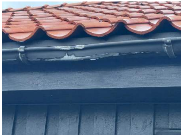
Bild 18: Utvändigt, Avvattning, - Läckage noteras på hängrännorna. Innebär ökad fuktbelastning på träpanelerna och garageportarna vilket tydligt syns vid nederbörd.
