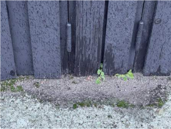
Bild 19: Utvändigt, Fasad, - Mycket träpanel har kontakt med marken vilket innebär risk för förtida fuktskador. Rekommenderar minst 15mm luftspalt mellan panel och...
