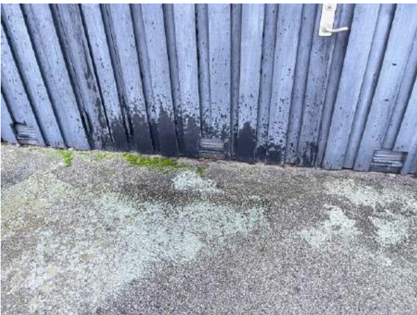
Bild 15: Utvändigt, Avvattning, - Läckage noteras på hängrännorna. Innebär ökad fuktbelastning på träpanelerna och garageportarna vilket tydligt syns vid nederbörd.
