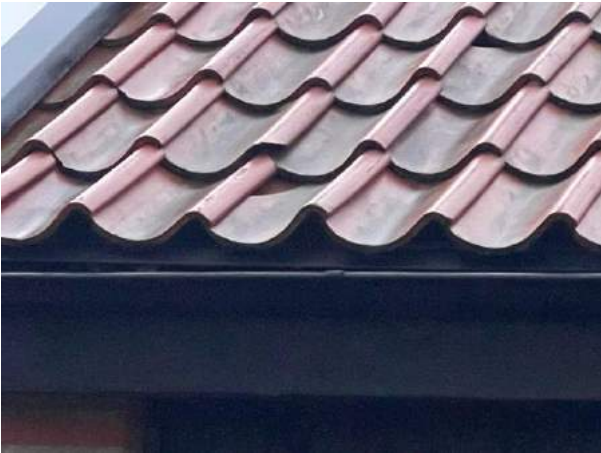
Bild 1: Utvändigt, Yttertak, - Det förekommer spruckna skadade tegelpannor. För att minska risken för fuktrelaterade skador på underlagstaket måste dessa ersättas.
