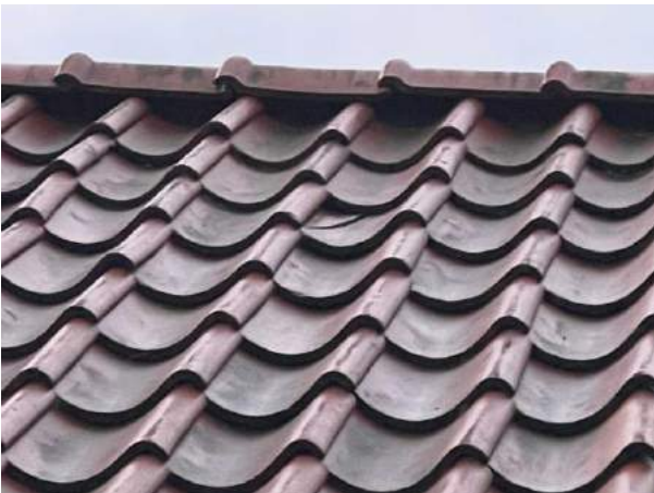
Bild 3: Utvändigt, Yttertak, - Det förekommer spruckna skadade tegelpannor. För att minska risken för fuktrelaterade skador på underlagstaket måste dessa ersättas.
