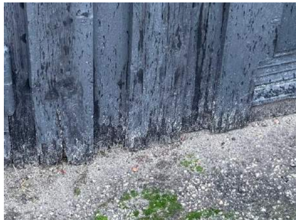
Bild 22: Utvändigt, Fasad, - Mycket träpanel har kontakt med marken vilket innebär risk för förtida fuktskador. Rekommenderar minst 15mm luftspalt mellan panel och...
