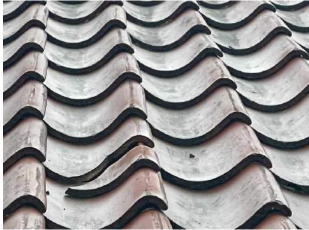
Bild 8: Utvändigt, Yttertak, - Det förekommer spruckna skadade tegelpannor. För att minska risken för fuktrelaterade skador på underlagstaket måste dessa ersättas.
